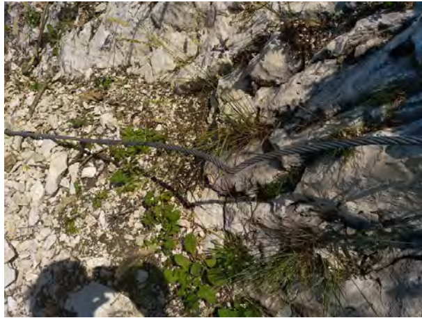
Main courante détériorée
